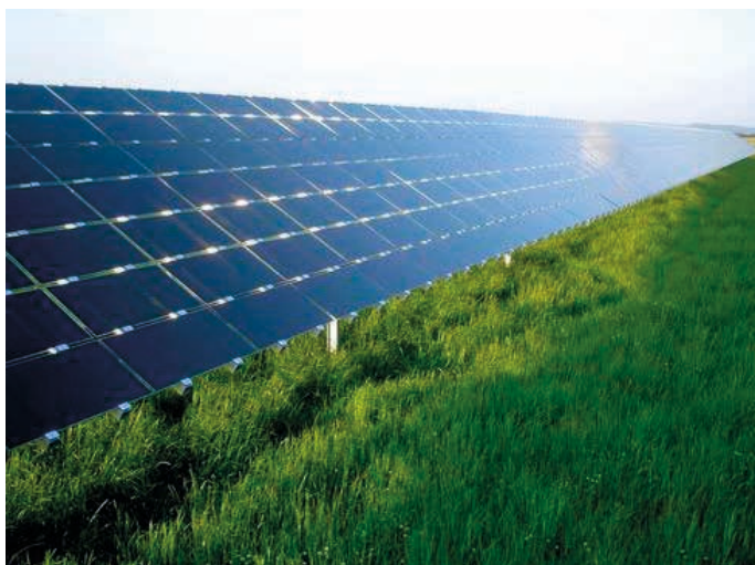
Fig. 214. Paneis solares que incorporan CdTe.
